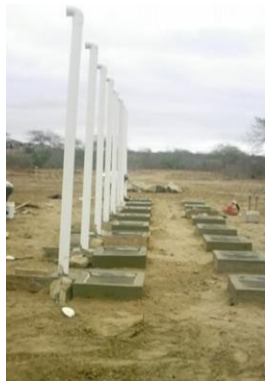
Imagen 10 vista superior del sistema sanitario, se aprecia las cajas de control y las tuberías de ventilación
