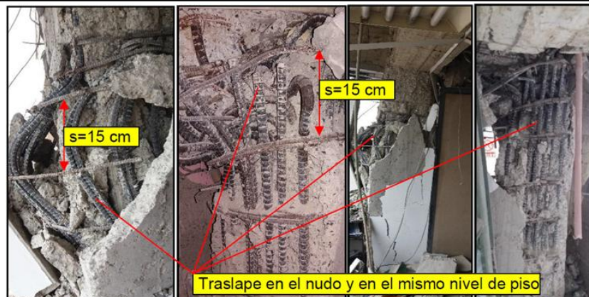
Figura 10. Daño de columnas nivel 5 edificio Mutualista Pichincha
