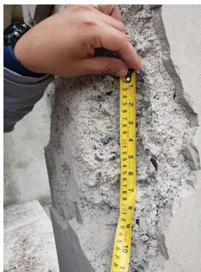
Figura 11. Separaciones ineficientes de estribos
