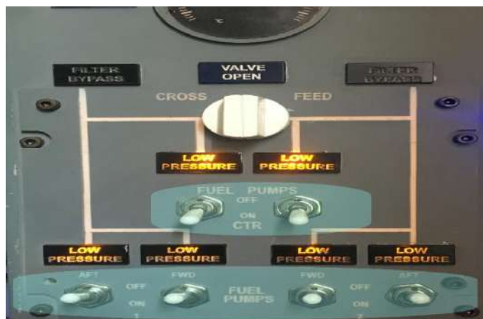
Figura.25. Interruptores de las bombas de combustible en la posición off
