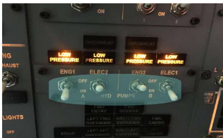
Figura.27. Interruptores hydraulic and electrical pumps a & b en posición ON Y OFF.
